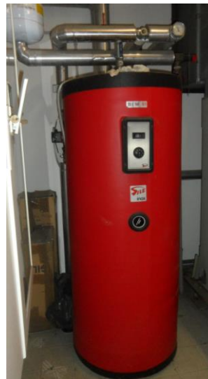
Figura 4.13 - Particolare bollitore ACS
