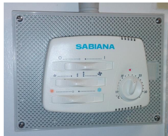
Figura 4.9 – Termostato di zona dei ventilconvettori
