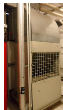
Figura 4.14 - Particolare della macchina frigorifera
