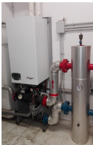
Figura 4.12 - Particolare della caldaia
