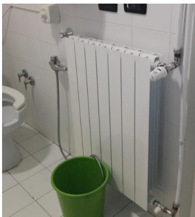
Figura 4.7 - Particolare dei terminali di emissione
